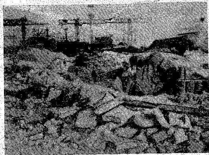
Такую свалку устроили на второй оборочной площадке монтажники и изоляционники.
